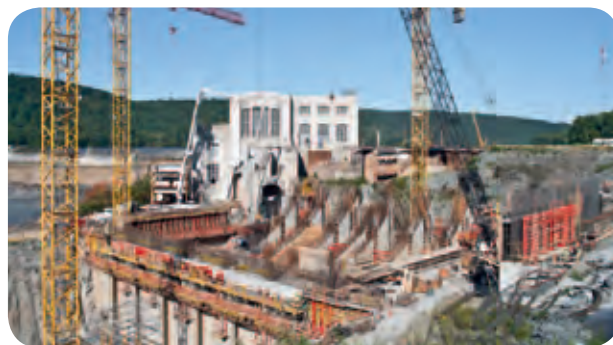
Гидроэлектростанция Холтвуда (г. Холтвуд, США)
